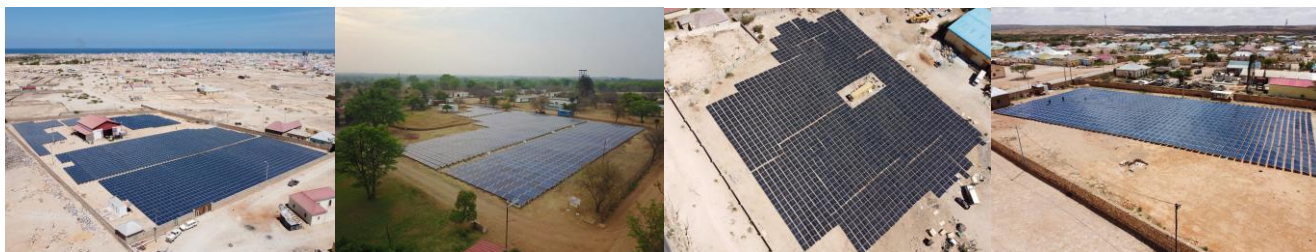
1.1 MW Réseau diesel, Puntland 0.5 MW Mine d'or, Zimbabwe 1.2 MW Réseau diesel, Somaliland 0.4 MW Réseau diesel, Puntland
